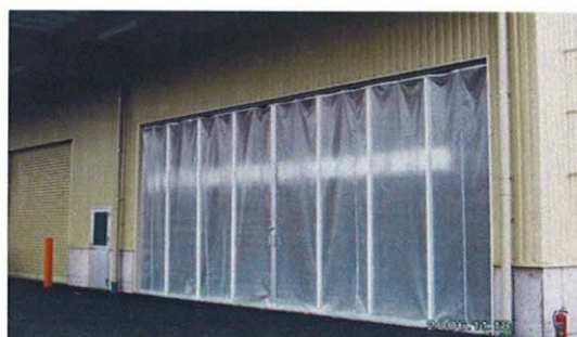
出入口風対策付パイプ入りカーテン
